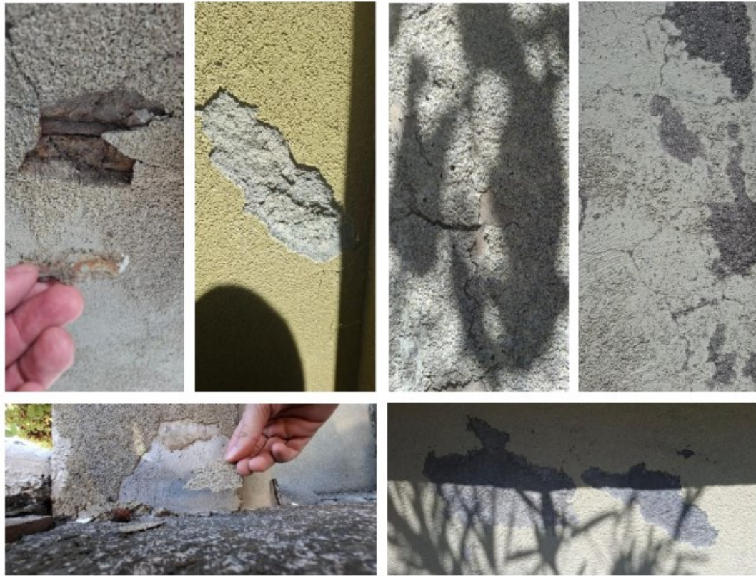
Textura orgánica suelta, soplada o desprendida, Pintura deteriorada, Estucos con desprendimientos.
