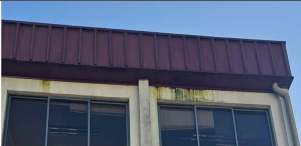
Cubierta Trapezoidal Metálica, Canales de aguas lluvia, cumbreras, limahoyas, limatesa, Filtraciones sobre la fachada.
