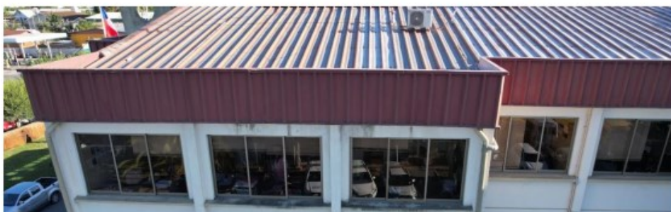
Petril perimetral Trapezoidal Metálico.
